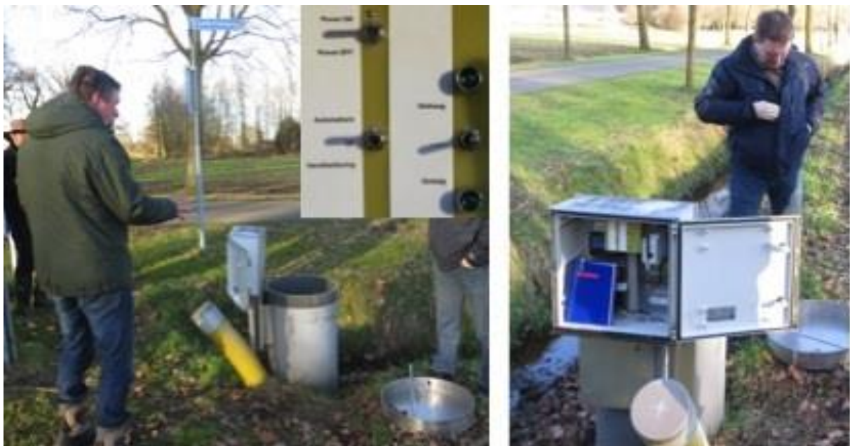
Figuur 4. Installatie voor Klimaat Adaptieve Drainage (KAD). (Foto: Lodewijk Stuyt (2016) ).
