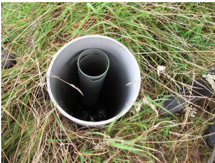
Figuur 2 Regelput om het ontwateringsniveau van de drainagebuizen in te stellen.
